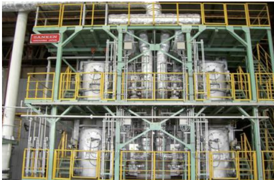
(バッチ式)加熱設備
